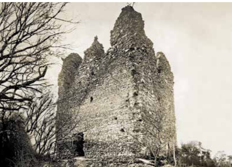
Eine Postkarte zeigt den Zustand der Mittleren Wartenberg vor der Restaurierung von 1934. Einige der Risse könnten im Erdbeben von 1356 entstanden sein (Foto bearbeitet, Tom Schneider).
