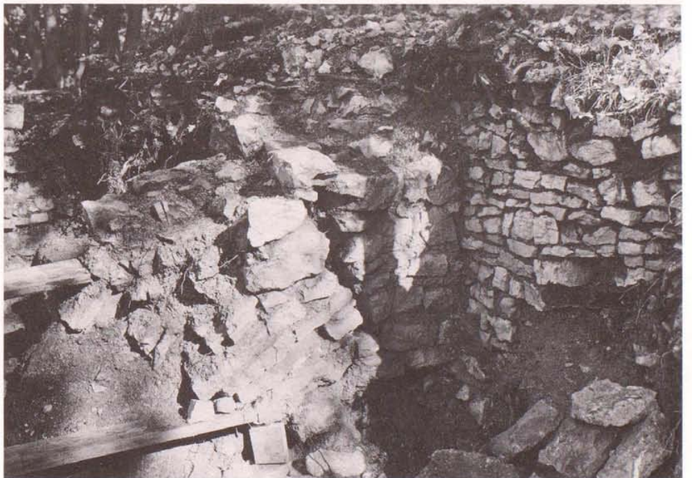
Abbildung 18 Südtrakt, Blick in die Nordostecke mit Aussenmauer (rechts) und deutlich anstossender Quermauer (Bauphase 2). Links ist der Ansatz zum Entlastungsbogen über der (jüngeren) Tankzisterne erkennbar.
