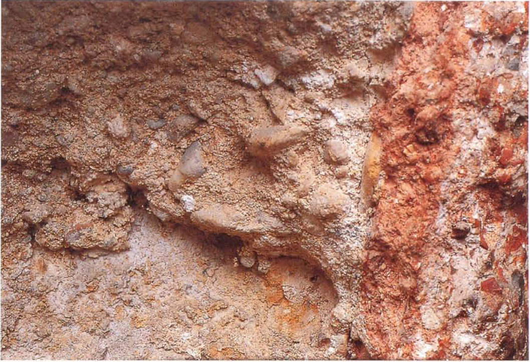
Abb. 42 Liestal Heidenlochstrasse (04). Detailansicht aus dem konservierten Teilstück, heute in August. Mauermörtel mit weissen, kreidigen Kalziteinschlüssen, die auf ein Trockenlöschchen des Branntkalkes hinweisen. Vgl. Abb. 45 und Abb. 49.
