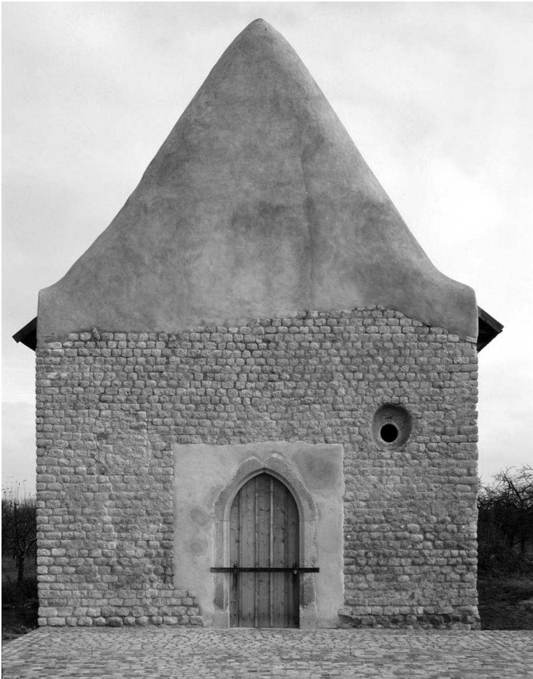
2 Heidesheim, Georgskapelle, Westfassade mit freigelegtem römischem Mauerwerk und im Spätmittelalter durchbrochenem Eingang.
