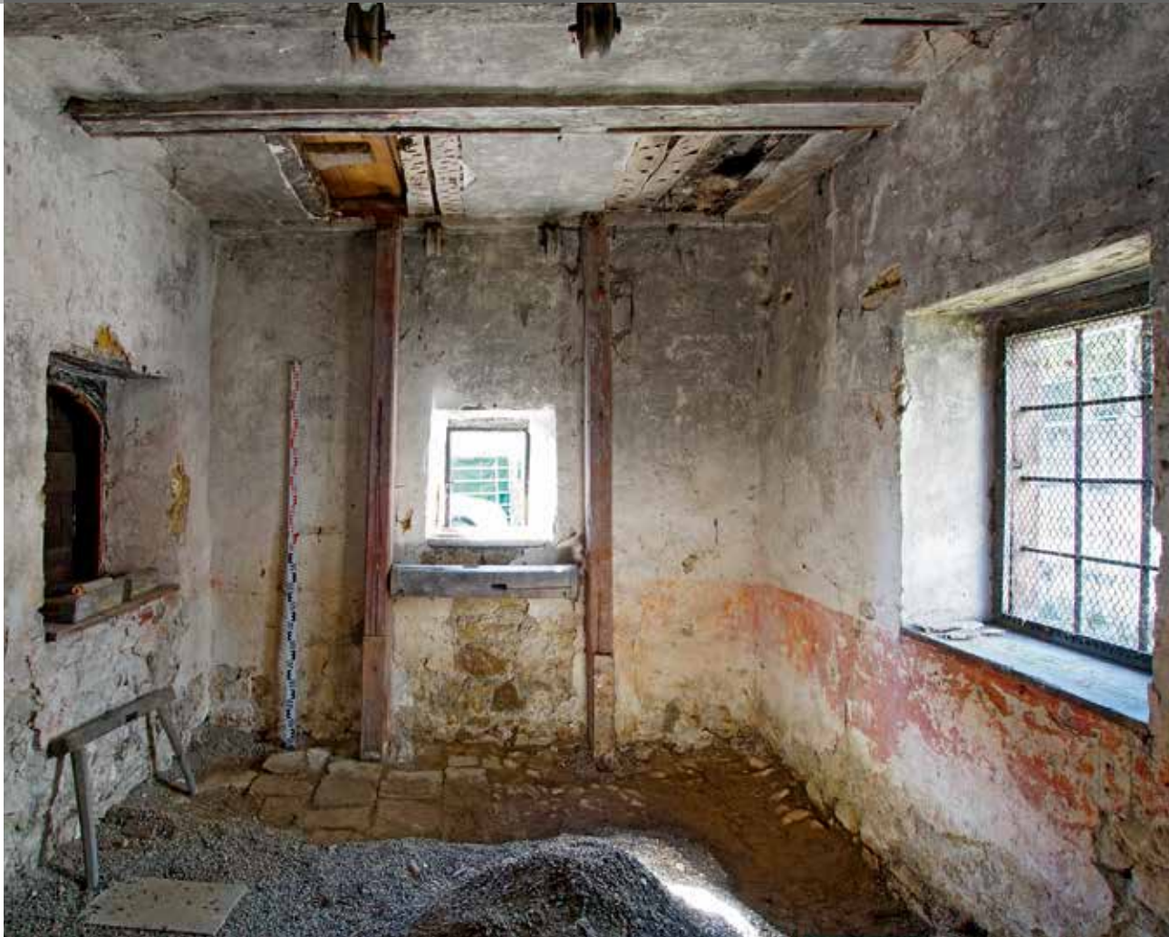
Ziefen, «Alte School», Hauptstrasse 105. Blick an die Ostwand mit Aufzugsvorrichtung und blutrot gestrichener Sockelzone.
