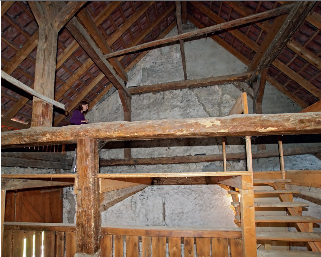
Ziefen, Kirchgasse 9. Claudia Spiess bei der Baudokumentation des Dachraums oberhalb des Tennis.
